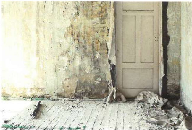
Schimmelpilz bleibt oft lange Zeit unentdeckt und kann sich in den Wohnräumen ausbreiten.
